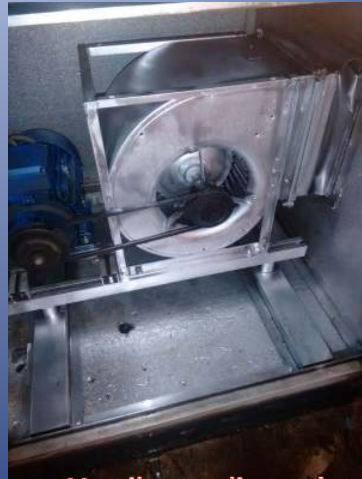
Ventilatore di mandata POST INTERVENTO
