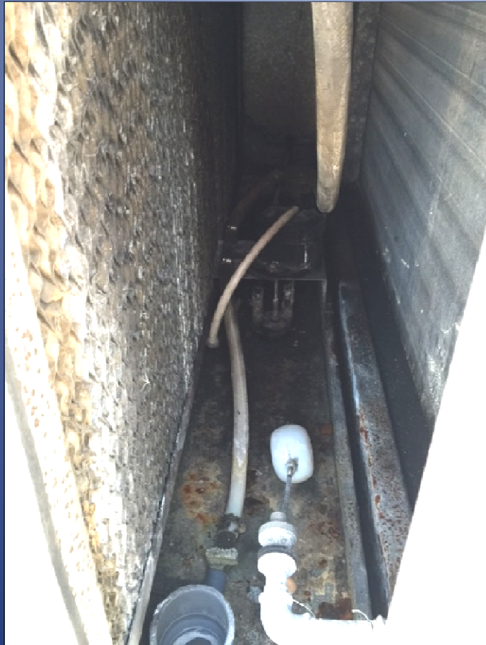
Vasca di umidificazione e pacco bagnato PRE INTERVENTO
