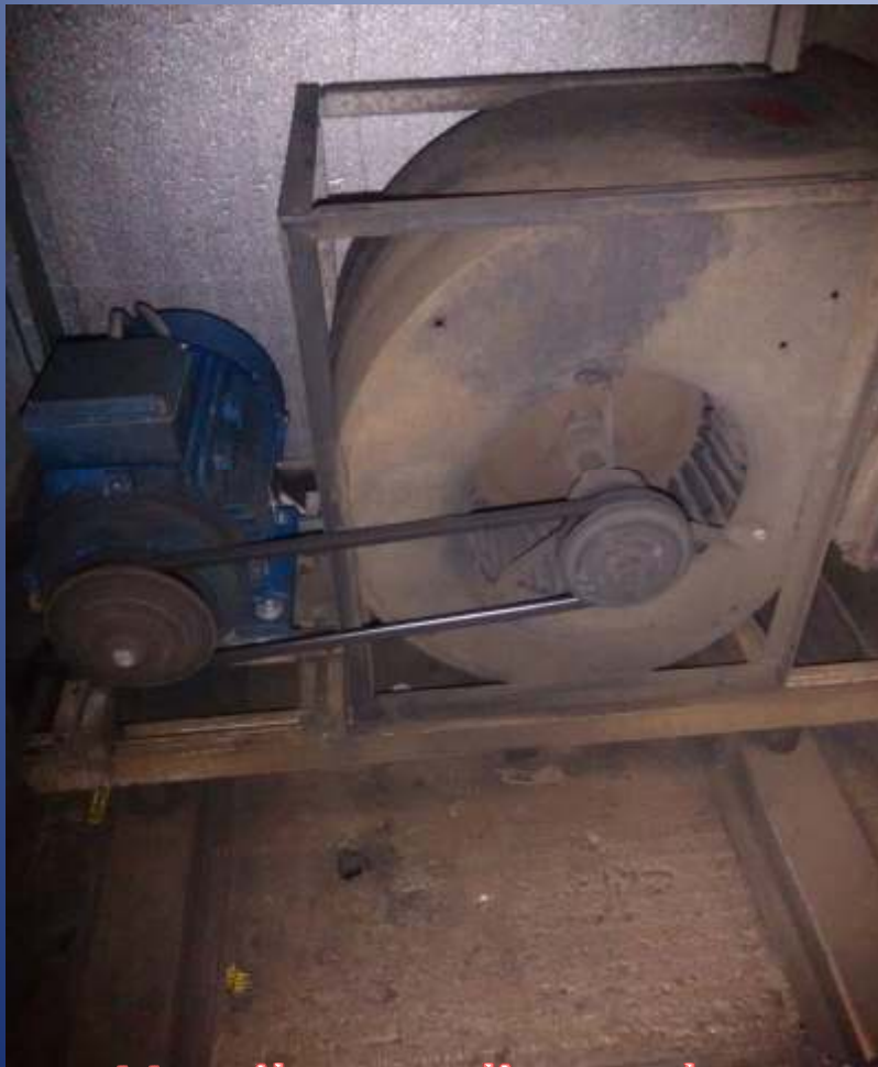
Ventilatore di mandata PRE INTERVENTO
