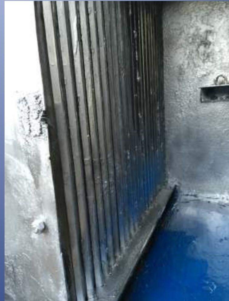
Separatore di gocce POST INTERVENTO
